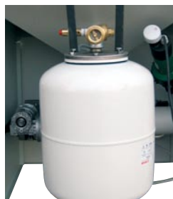
Tryktank til sprinkleranlæg, efter BTV32.
