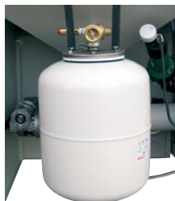
Tryktank til sprinkleranlæg, efter BTV32.
